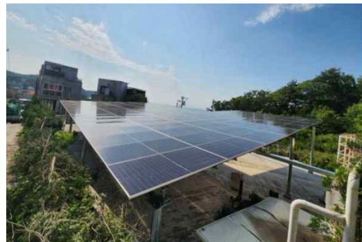
인천 빠세 태양광발전소 99.63kW
