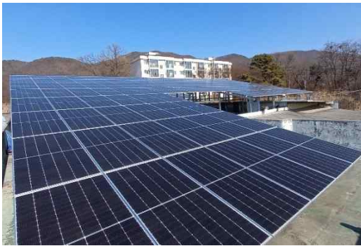
파주 리빙센스 태양광발전소 98.88kW
