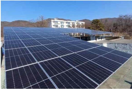
파주 리빙센스 태양광발전소 98.88kW
