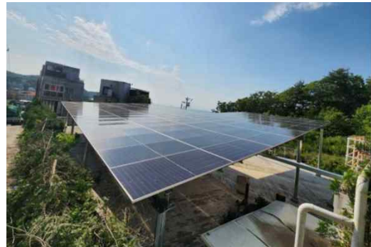
인천 싸쎌 태양광발전소 99.63kW
